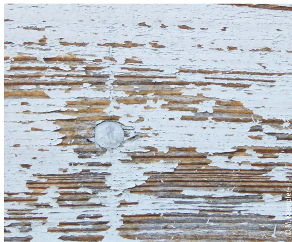
Solch ein verwitterter Altanstrich muss restlos entfernt werden
