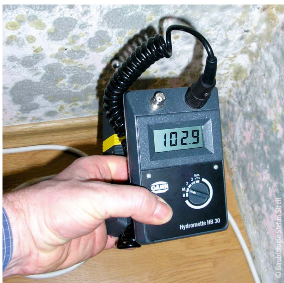
Schimmelpilzwachstum durch zu viel Feuchtigkeit in der Raumluft, kühle Oberflächen und fehlende Feuchtespeicherfähigkeit
