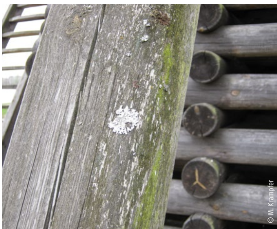
Fortgeschrittener Bewuchs auf der Wetterseite
