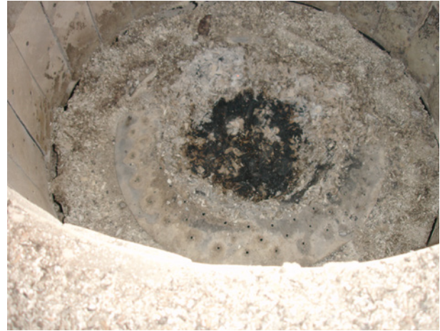
Abb. 3-2: Hackschnitzelheizung (300–500 kW), Detail: Brennraum mit Unterschubfeuerungs/Glutbett, Primärluftdüsen im Brennteller, Ascheabreinigung durch Rüttelvorrichtung
