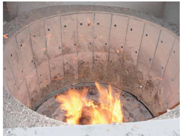
Abb. 3-3: Hackschnitzelheizung (300–500 kW), Detail: Brennraum, Brennstoffzufuhr im Unterschub, Sekundärluftdüsen in der Seitenwand
