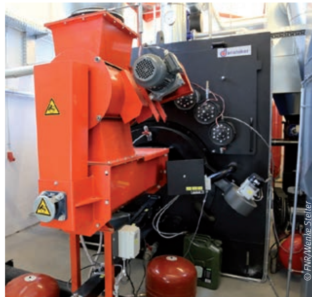
Heizkessel mit Strohzuführung
