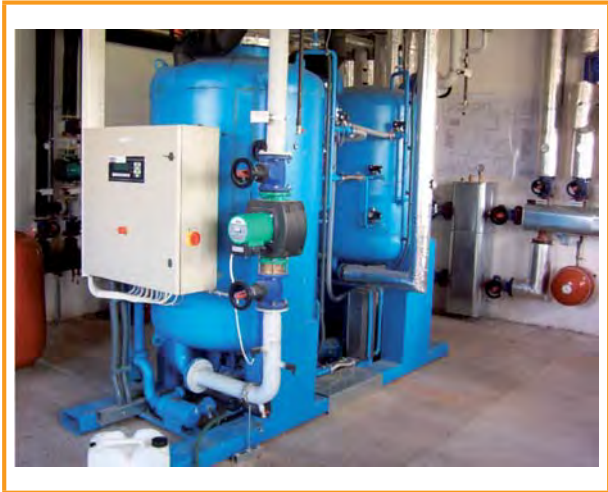
Şekil 6.14: Bir biyogaz tesisinde absorbsiyon soğutma makinesi örneği [DBFZ]
