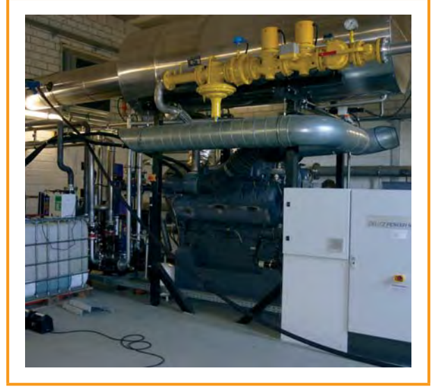
Şekil 6.8: Gaz kontrol hatlı BHKW [DBFZ]
