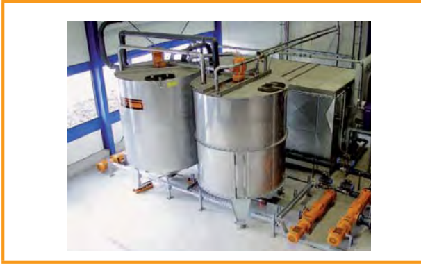
Şekil 3.10: Soğutmalı hijyenleştirme [TEWE Elektronik GmbH & Co. KG]
