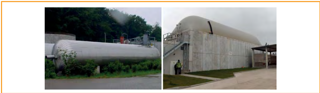
Şekil 3.25: Tapa akışlı fermentör; uygulama örnekleri, silindirik (solda), dikdörtgen, üstünde gaz deposu mevcut (sağda) [Novatech GmbH (solda), DBFZ (sağda)]
