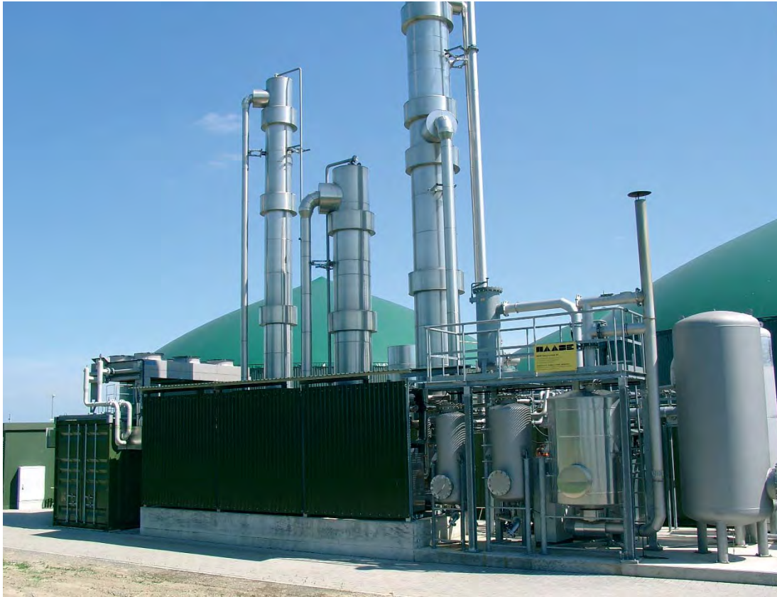
Şekil 6.3: Biyogaz hazırlama tesisi (genosorb yıkama), Ronnenberg [Urban, Fraunhofer UMSICHT]
