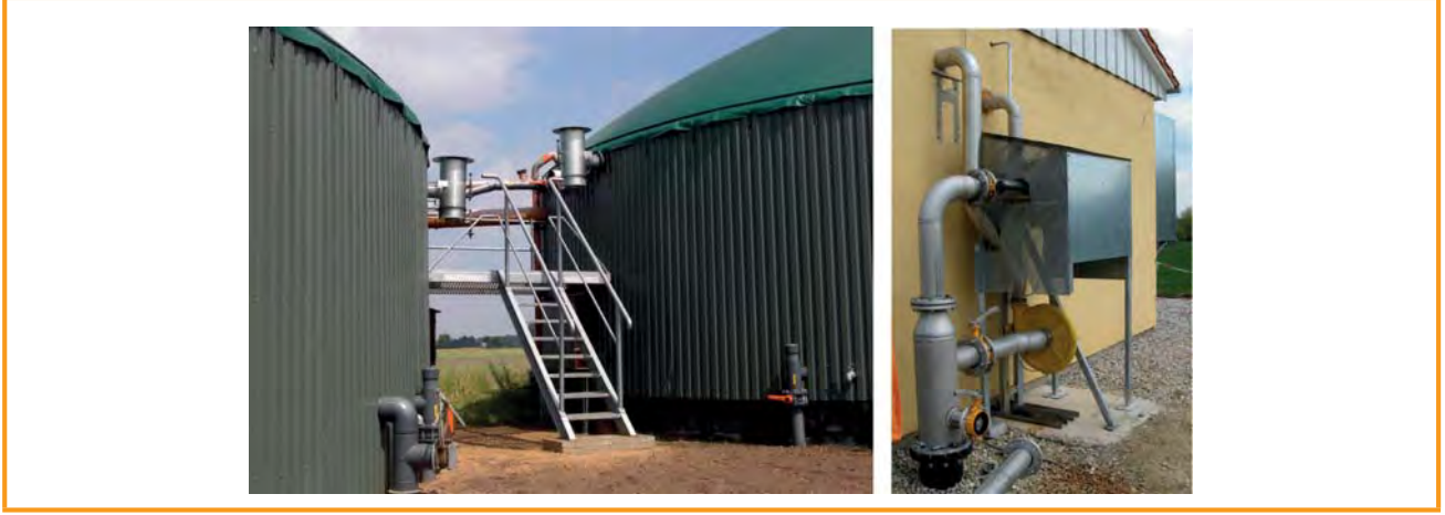
Şekil 3.21: Boru hatlı ve basınç koruyuculu iki tank arasında çalışma alanı (solda); kompresör fanlı gaz hattı (sağda) [MT-Energie GmbH (solda), DBFZ (sağda)]
