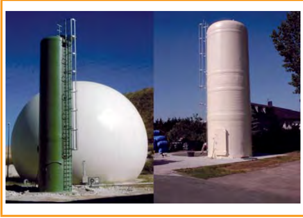
Şekil 6.2: Harici biyolojik desülfürizasyon sütunları, sağda bir gaz deposunun yanında [S&H GmbH & Co. Umwelt-engineering KG]
