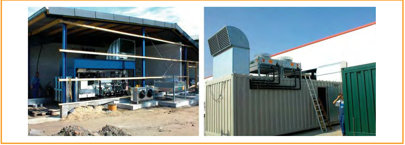
Şekil 6.9: Bir binanın ya da konteynır içindeki BHKW [Seva Energie AG]
