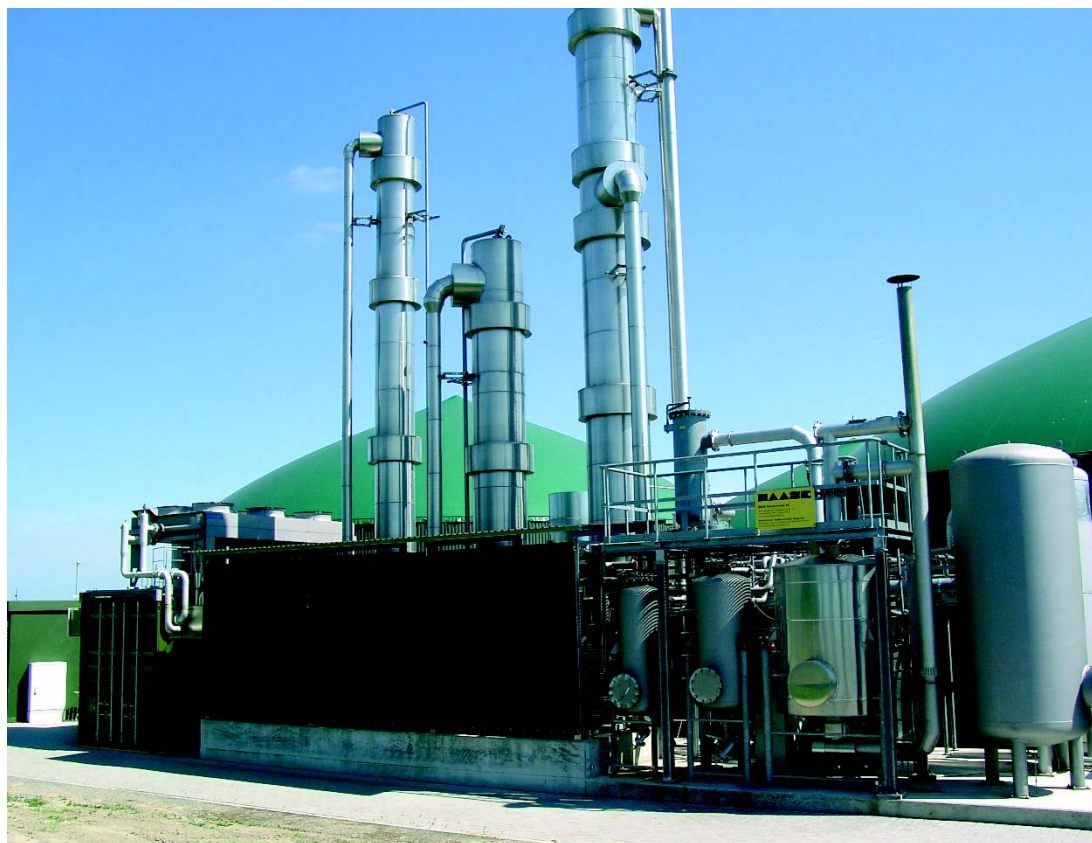
Figura 6.3: Planta de tratamiento de biogás (limpieza con Genosorb) en Ronnenberg [Urban, Fraunhofer UMSICHT]
