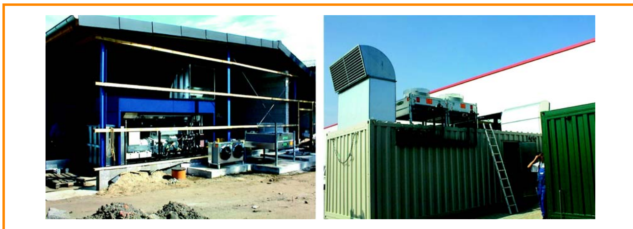
Figura 6.9: Instalación de una unidad de CHP bajo techo y en un contenedor de CHP [Seva Energie AG]
