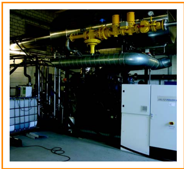
Figura 6.8: Unidad de CHP con tren de control de gas [DBFZ]
