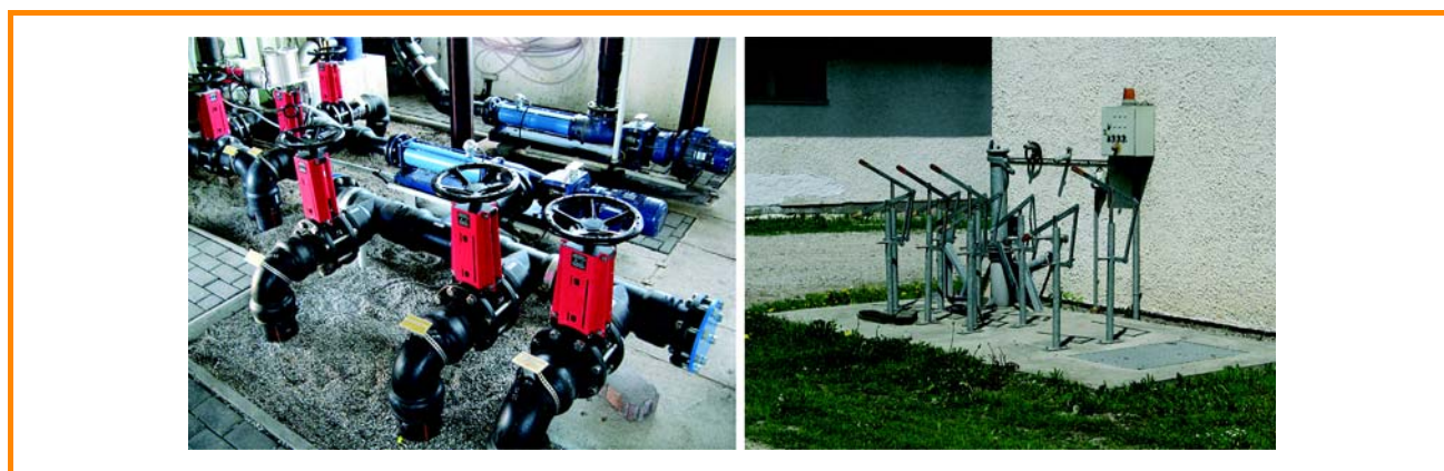
Figura 3.20: Tuberías, válvulas y accesorios de la estación de bombeo, y válvulas de cierre [DBFZ]
