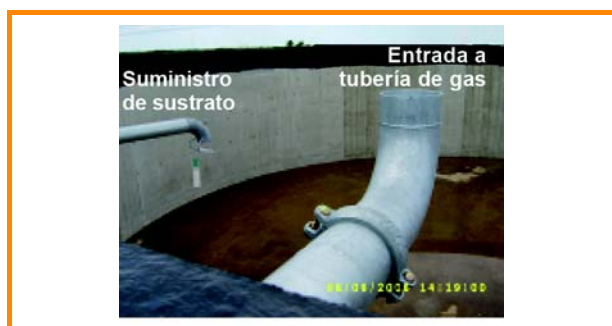
Figura 3.36: Dispositivos para impedir la interrupción de la extracción de gas. El ingreso de la tubería de gas con la apertura de la toma hacia arriba (a la izquierda está la entrada de alimentación del sustrato) [DBFZ]
