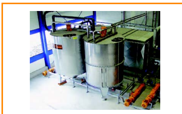
Figura 3.10: Higienización con re-enfriamiento [TEWE Elektronik GmbH & Co. KG]
