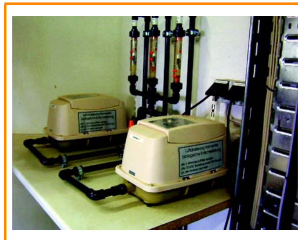
Figura 6.1: Sistemas de control del gas por inyección de aire en el espacio de gas del digestor [DBFZ]
