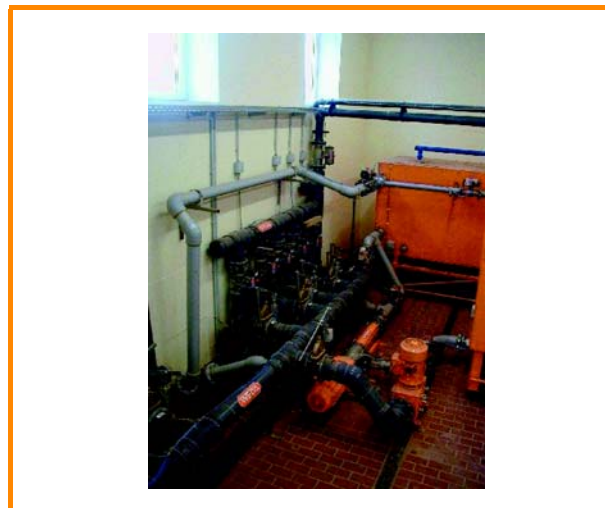
Figura 3.11: Bomba según la planta de biogás [WELtec BioPower GmbH]
