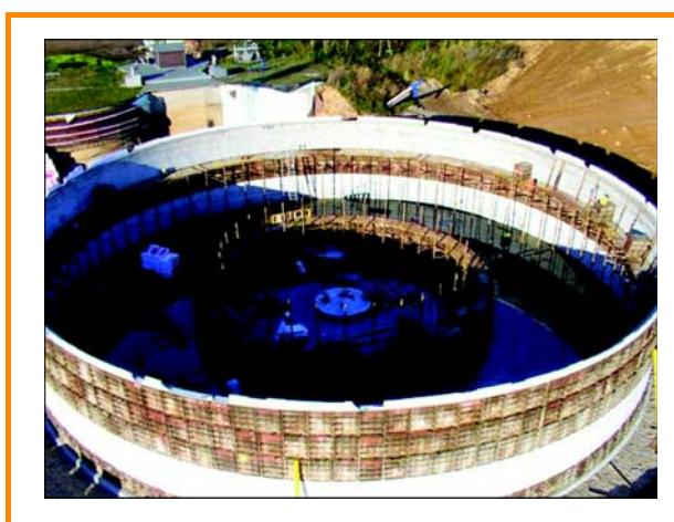
Figura 3.29: Un digestor de concreto en construcción [Johann Wolf GmbH & Co Systembau KG]
