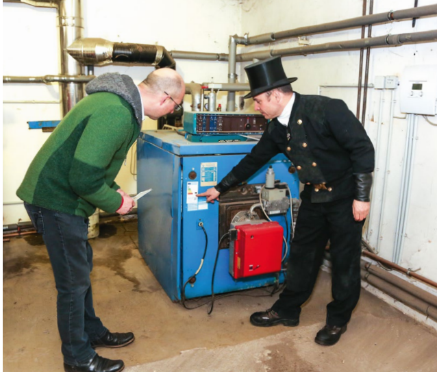
Bezirksschornsteinfegermeister labelt alten Heizkessel und informiert über den Handlungsbedarf
